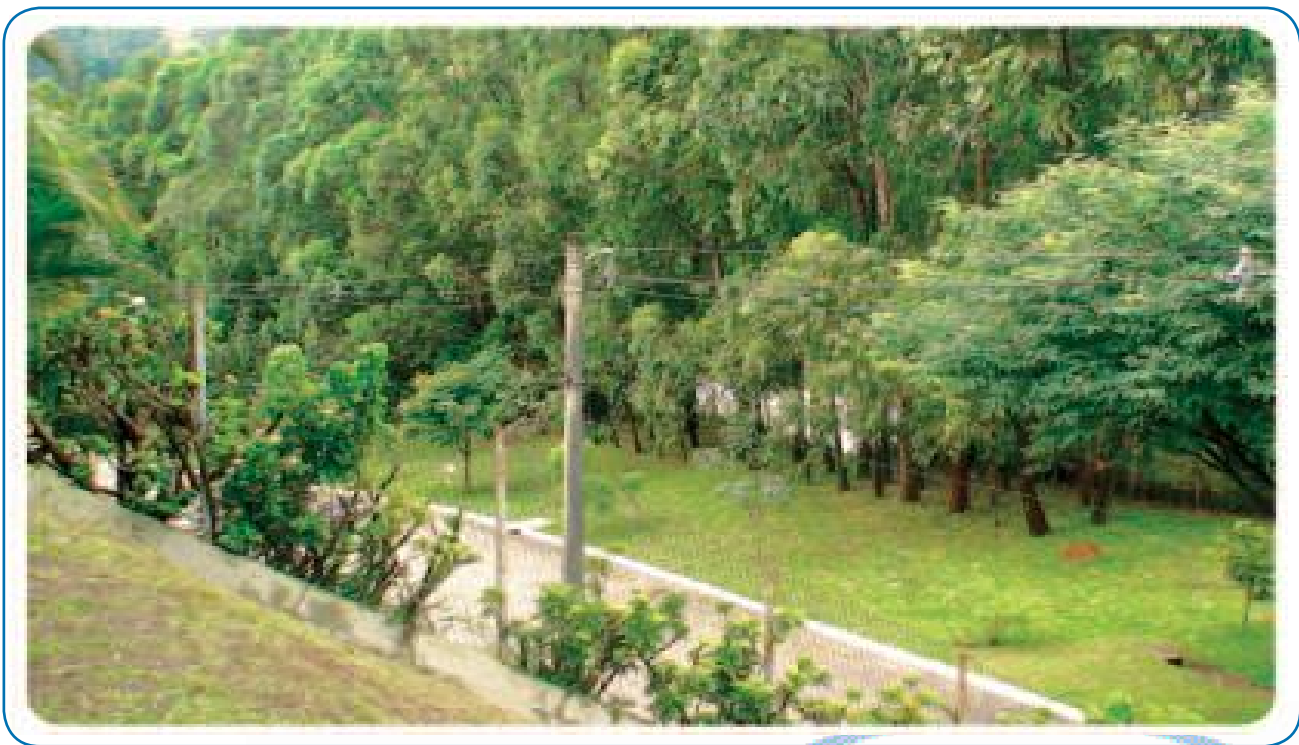
Línea Compacta en las instalaciones de PLP, en Cajamar - SP
